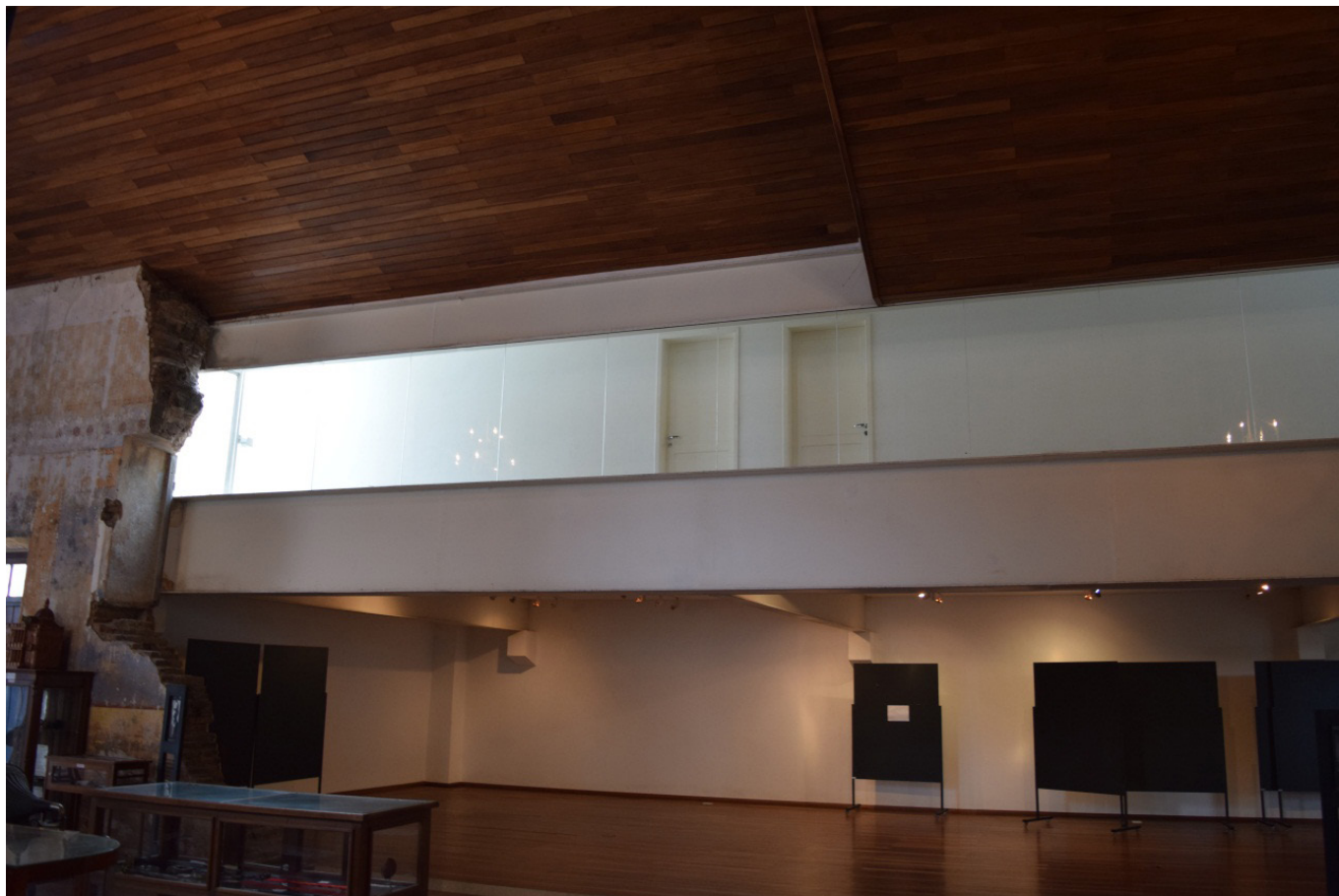
Figura 3: Interior do Museu Nossa Senhora do Rosário Bonfim (Igreja do Galo), percebe-se a parede destruída pela retroescavadeira e a parte moderna que serve de reserva técnica e arquivo para o museu no andar superior, no inferior existe um espaço para exposições temporárias.
